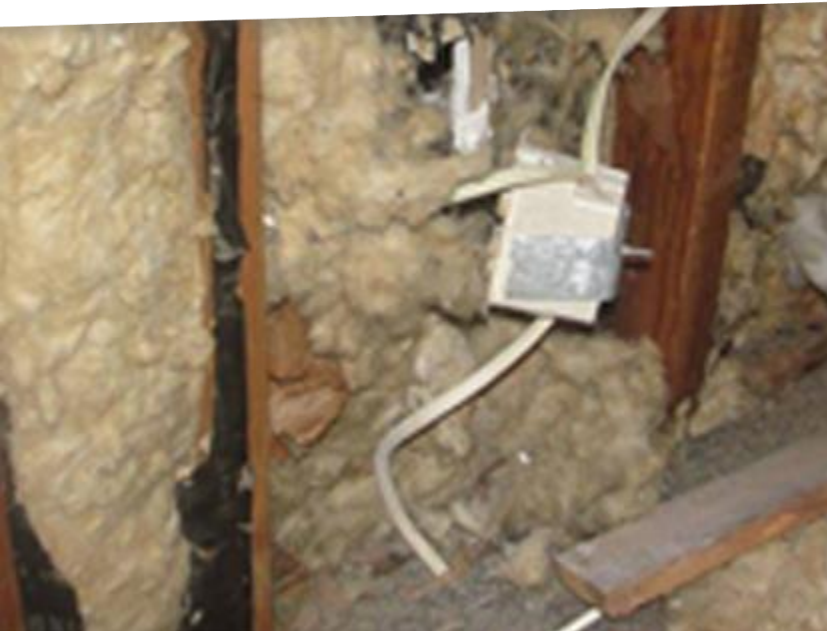
1. Photo : Laine de verre dégradée, sans frein-vapeur
